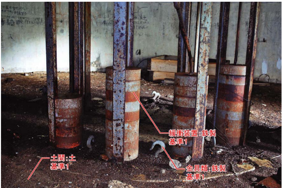
写真62 緩衝装置(1号塔)
