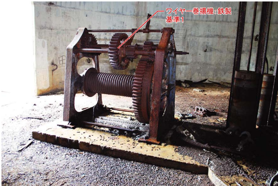
写真61 ワイヤー巻揚機(1号塔)
