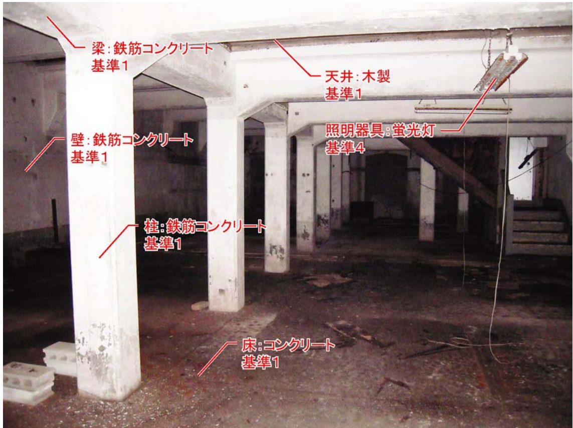
写真55 ⑪整流器室
