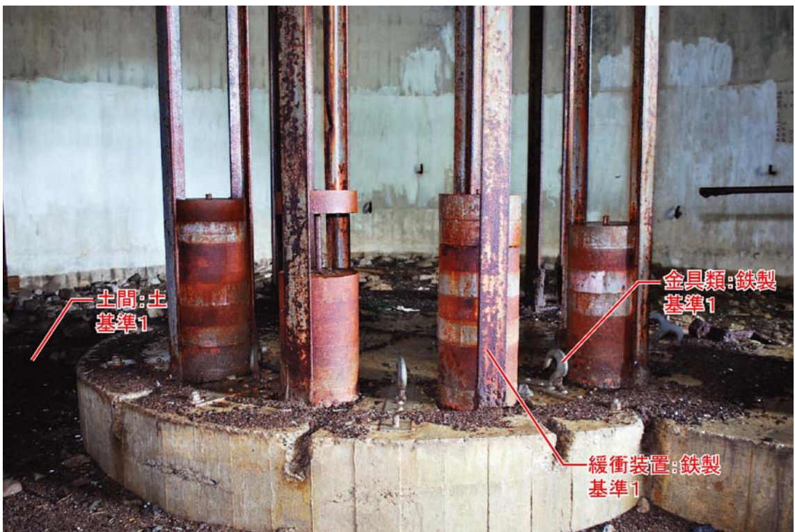
写真68 緩衝装置(2号塔)
