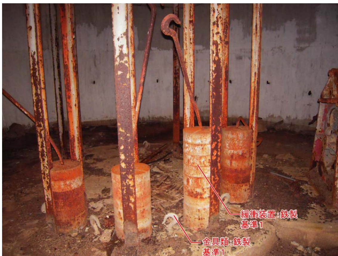
写真74 緩衝装置(3号塔)
