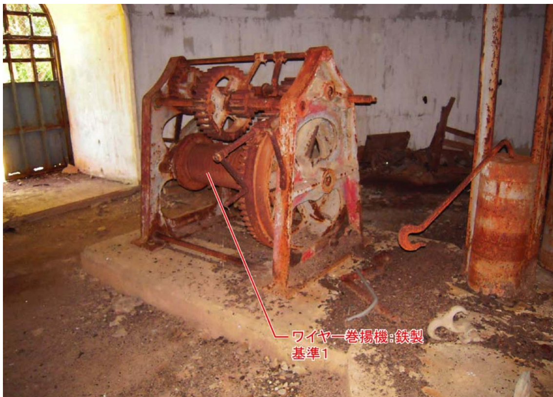
写真73 ワイヤー巻揚機(3号塔)
